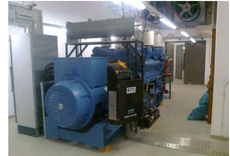
2 x 2150 kVA Star 22 Rechnerzentrum MA 47 Wien
