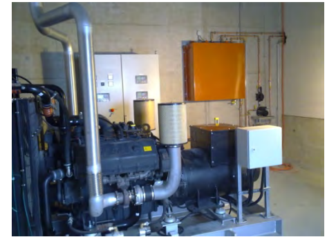
650 kVA HELLWACHT Wien
