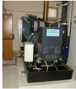
350 kVA im Beton Container Pflanzen Kölle Wiesbaden
